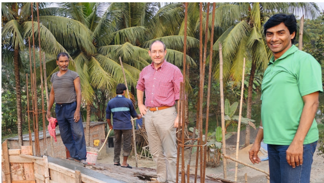
Auf der Baustelle: Provinzial Christian Rutishauser SJ (Mitte) mit Pater Saju SJ (re.) auf dem Dach der künftigen Kirche des Kunst- und Kulturzentrums Kalahrdya in der Nähe von Kalkutta.
