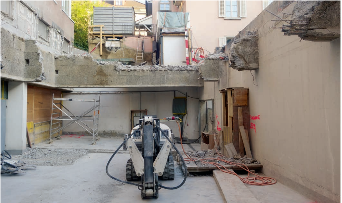
Blick nach oben von der Tiefgarage aus: Die künftige Bibliothek befindet sich ein Stockwerk höher auf dem neu gegossenen Betondach.
